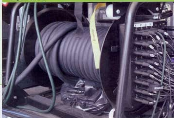
Il Power Master sotto il banco di palco ai Giardini Carducci, un unico pannello con avvolgitore, cavo specifico, maniglione e ruote integrate a scomparsa, dove arrivano e partono le 48 linee a disposizione splettate tra palco e sala. La linea di arrotolatori RDQC, brevettata, ha il grande vantaggio di poter essere customizzata a seconda delle esigenze rimanendo dotata del cavo RSC multicoppia, costruito per affrontare lo stress elettrico e meccanico del live. Da questo partono i local box a otto canali distribuiti sui vari punti del palco dove vengono collegati i microfoni.
